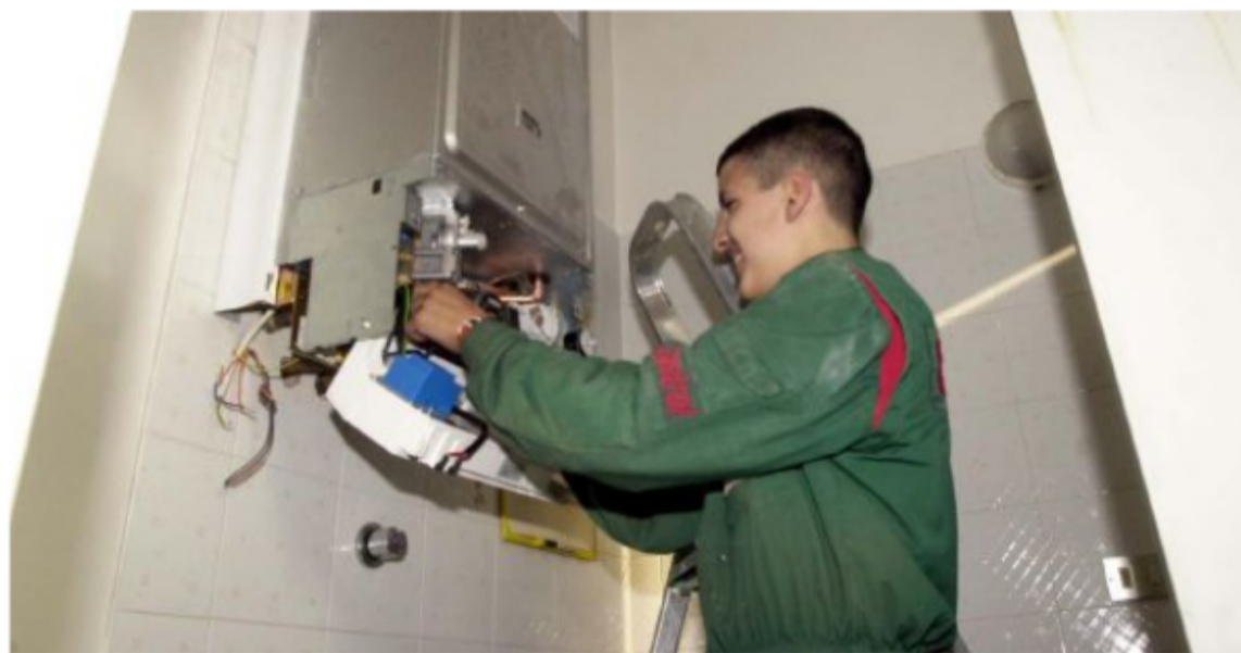
Mirco Galeazzi, un'industria tessile e l'installatore di una caldaia
